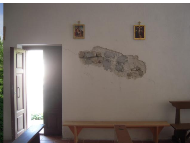
Fig.4: particolare fessurazione parete fig.3
